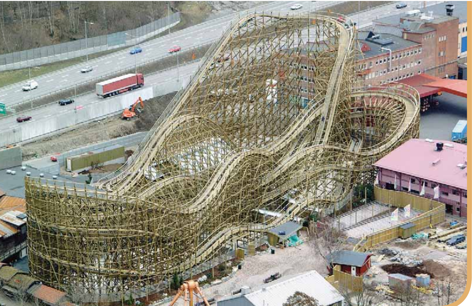
Lisebergs senaste attraktion, berg-och-dalbanan Balder, har gett anläggningen en ny profil. Det gitterliknande byggnadsverket är en komplicerad fackverkskonstruktion i trä, unik för Sverige. Delarna i fackverket är förtillverkade i Tyskland och monterade på plats som ett jättelikt "trämekano".
