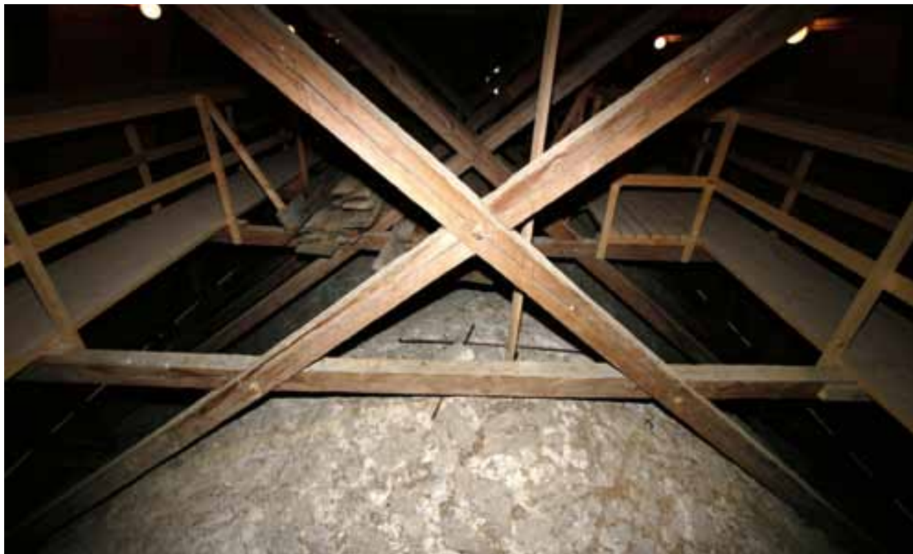
Exempel på förband halvt i halvt mellan hanbjälke och saxsparrar. Norrlanda kyrka på Gotland.
